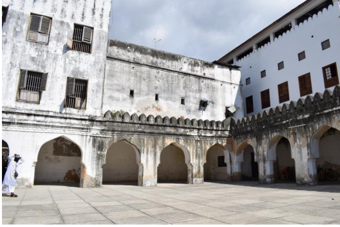
لوحة (٦) الجداران الجنوبي الشرقي والشمالي الشرقي للفناء المكشوف "بيت الأميرة سالمة بنت سعيد" (تصوير الباحثة)
